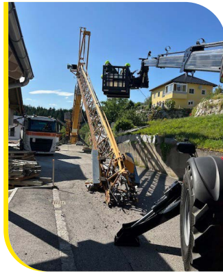
Ungewöhnlicher Einsatz zu umgestürzten Kran
